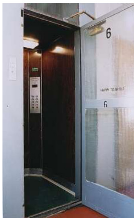
Kabina výtahu před opravou
